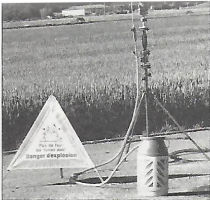
Le danger a été écarté quand la tor- chère mise en place a canalisé et brûlé le gaz
